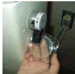
③大便器洗浄レバー部分 (本社1階男子トイレ)
